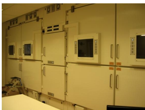
2008 utvidgades radiokemilaboratoriet en sista gång för att kunna installera fyra dubbla hot-celler för syntes av radiofarmaka och två hot-celler för distribution av radioaktiva gaser och vätskor från cyklotronen till laboratoriet.
